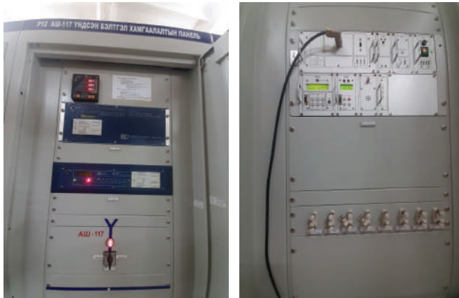
Зураг-5 117-р агаарын шугамын шинээр суурилуулсан реле хамгаалалтын панель
