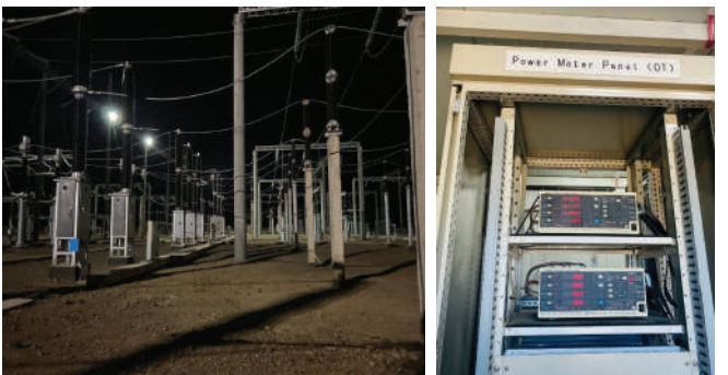
Зураг-3 220/22/35кВ -ын Цагаансуварга дэд станц
