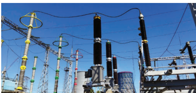
Зураг-9 TYD-245/3-0.01H маркийн хүчдэлийн трансформатор суурилуулсан.
