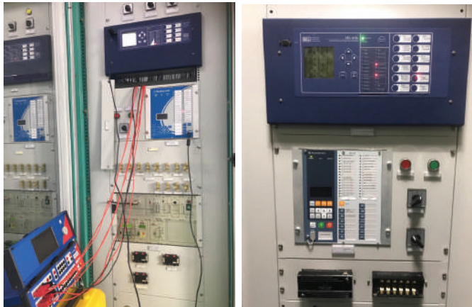
Зураг-2 МП-ын хамгаалалт шалгаж, туршиж байгаа байдал
